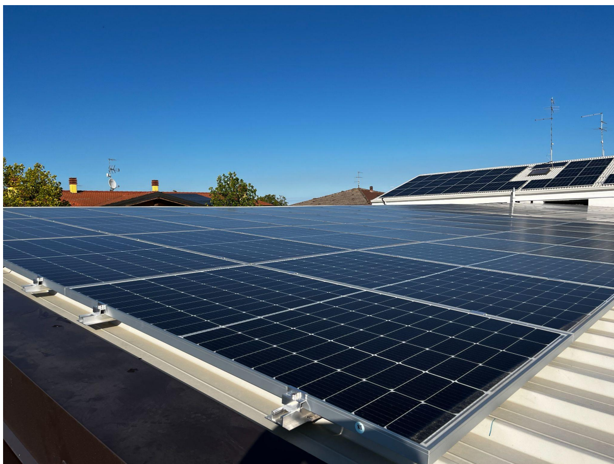
Pannelli fotovoltaici sul tetto
