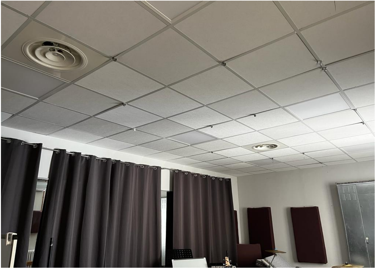
Ventilazione meccanica controllata nelle aule
