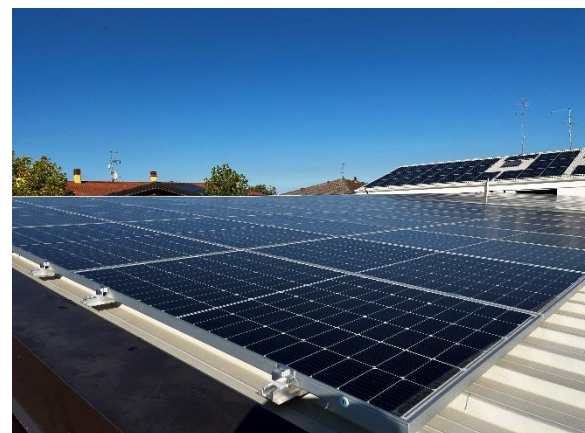
Figura 9 foto dell'impianto fotovoltaico
